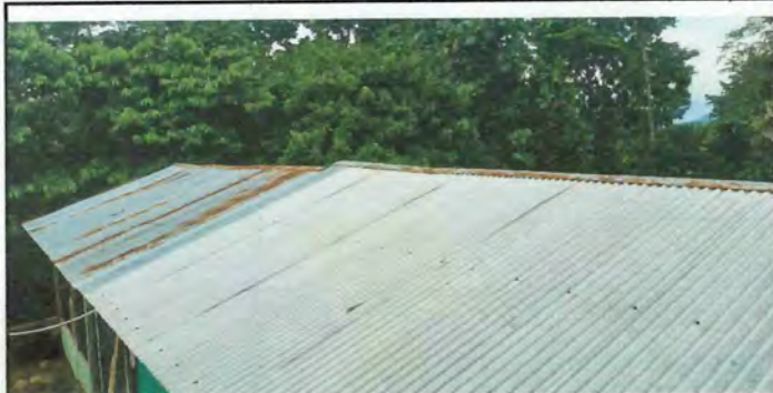
Foto 1: Se hará el cambio de la cubierta de lámina por láminas mas gruesas y resistentes. La que está son láminas muy delgadas y caliente mucho en época de verano.
