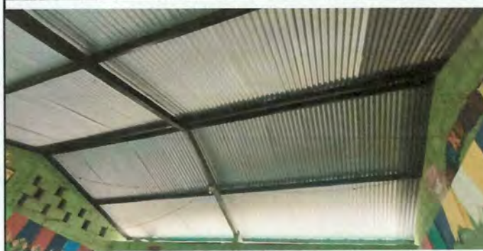
Foto 2: Se cambiará la estructura metálica con materiales mas resistente y legitimo, la que está son estructuras de muchos años y en unos ya se encuentran picadas y oxidadas.
