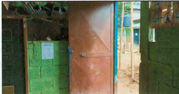
Foto 2: Puerta que requiere mantenimiento del aula de preprimaria.
